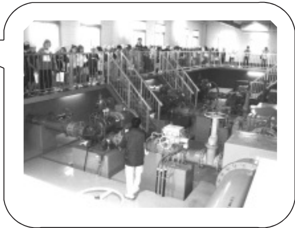
ポンプ室：県から送られてきた水をポンプにより各家庭へ配水します
