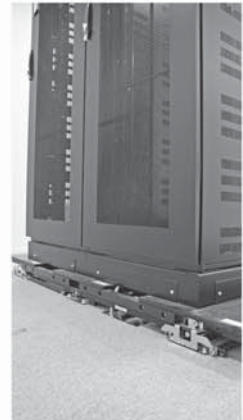
サーバー室の免震装置
