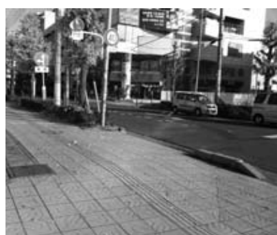
経年劣化による段差の解消を
