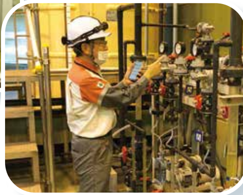
適切に次亜塩素素注入機が稼働しているか確認している様子
