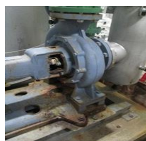
ろ過装置ポンプ状況
