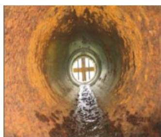
起流ポンプ配管内部状況
