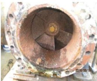
起流ポンプ内部状況
