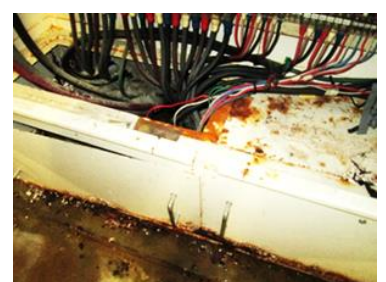
制御盤内部状況
