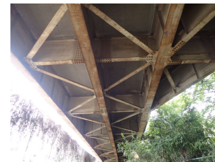
損傷例：鋼桁の腐食
