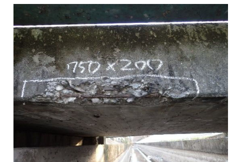
損傷例：コンクリート主桁の鉄筋露出
