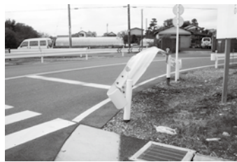
事故により壊された道路施設
