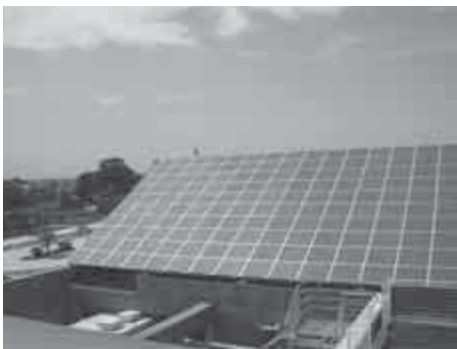
太陽光パネル
