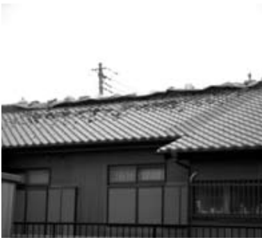
地震により破損した屋根瓦
