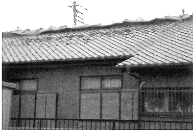
地震により破損した屋根瓦
