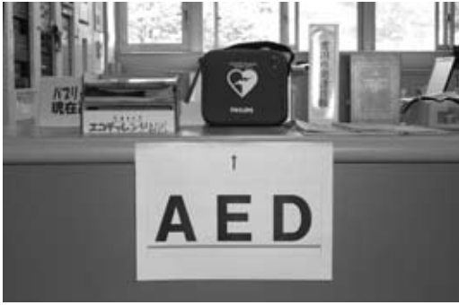
公共施設に設置されているAED
