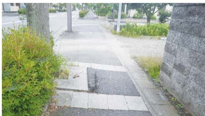
歩道の根上がりのようす
