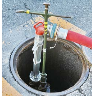
放水口に取り付けられたスタンドパイプ
